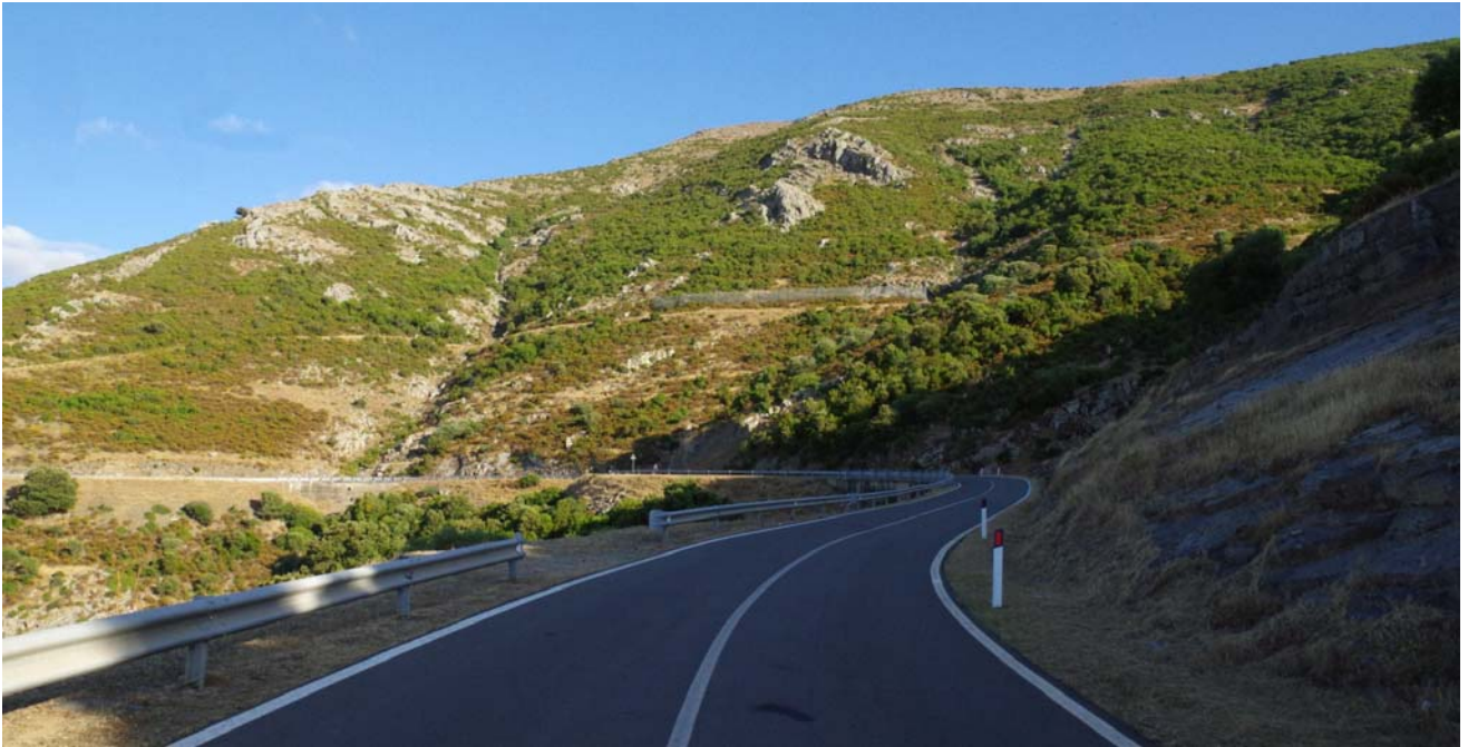
Foto – Affioramenti rocciosi sopra la Arbus - Montevecchio esposti a crollo (in foto reti paramassi)
