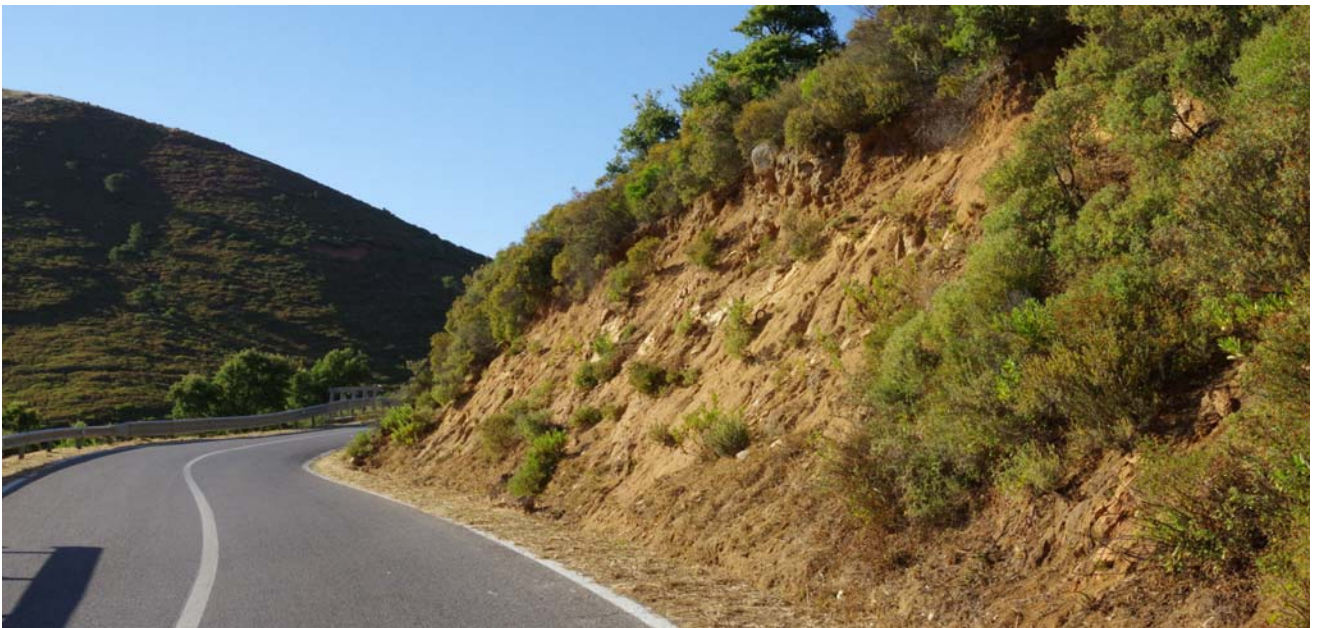
SP 68 Arbus – Montevecchio - Taglio stradale al limite della stabilità a Genna Sciria (Comune di Arbus) su granodioriti profondamente alterate
