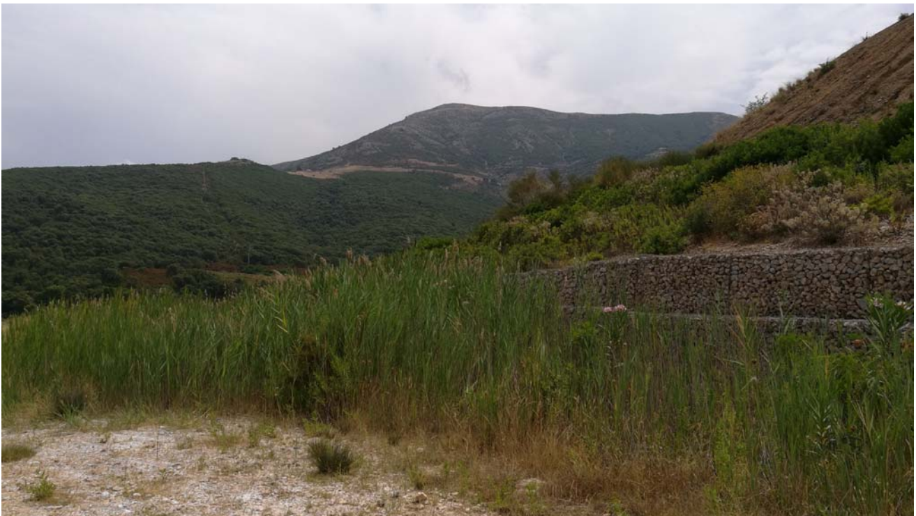
Argini in gabbionata per il confinamento del piede della 3° diga, con presenza di erosione areale e concentrata del paramento della diga e permeazione di acque dal piede del paramento stesso che alimenta la crescita del canneto
