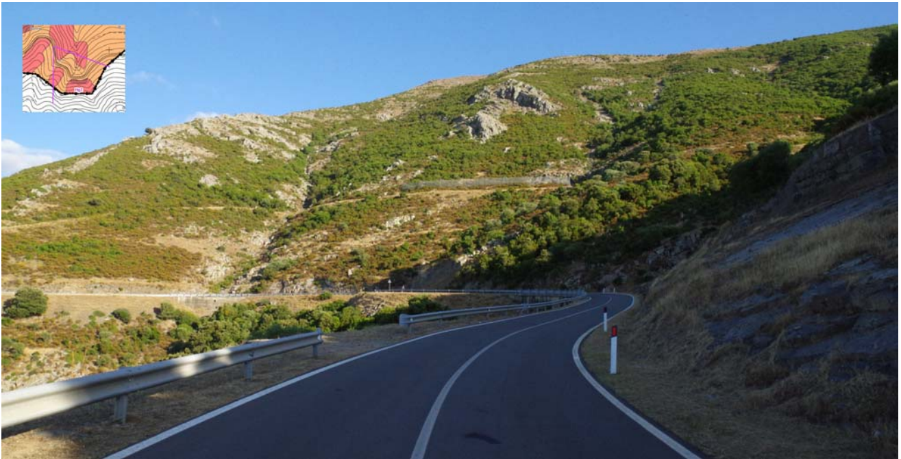
SP 68 Arbus – Montevecchio - Tratto di scarpa di monte “stabilizzato” con reti su metamorfiti
