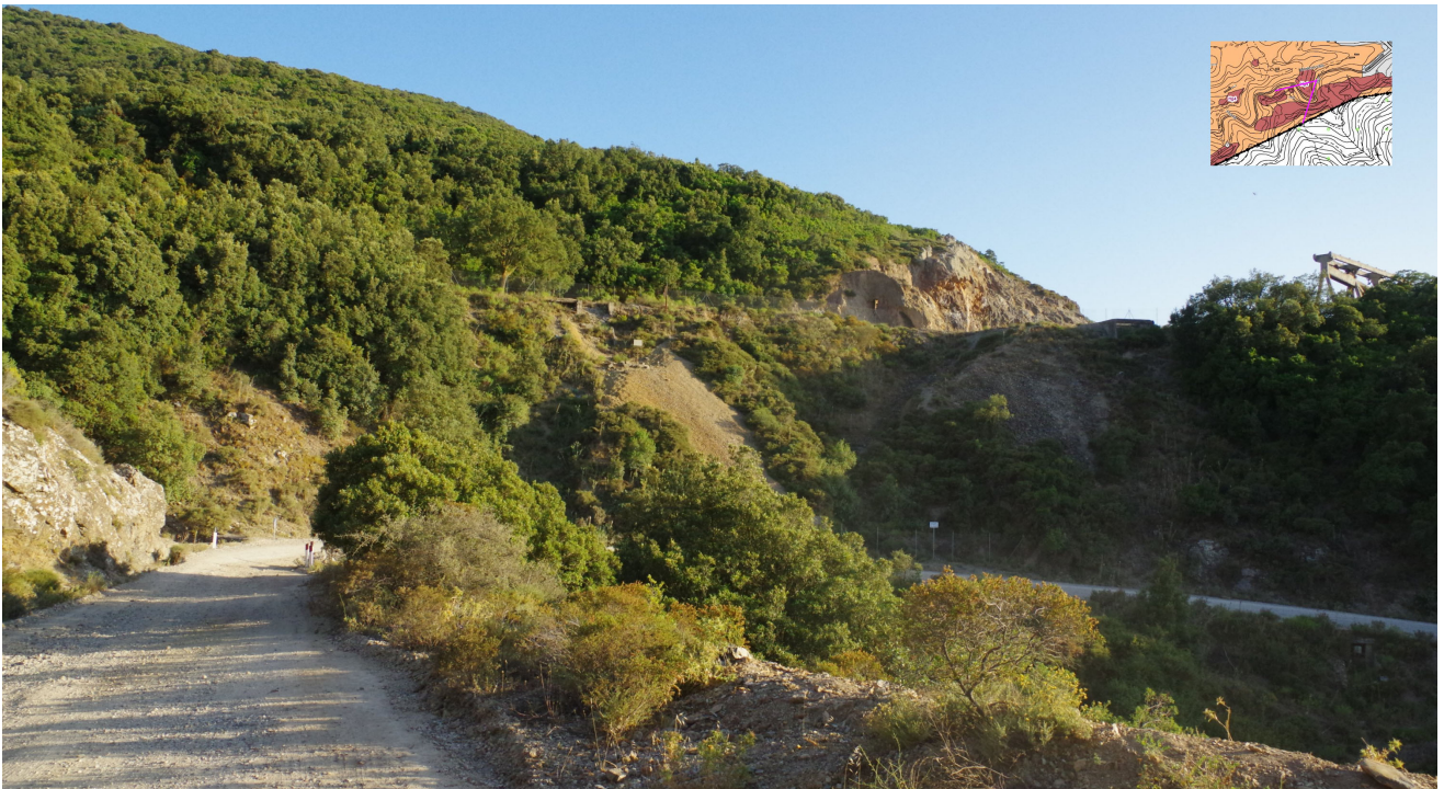
Il settore della ex aspirazione Minghetti (crollata a causa dei collassi delle aree di coltivazione sub superficiali)
